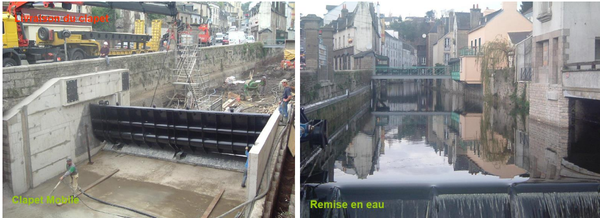
Aménagement du clapet mobile (Photo 37: en phase travaux, et Photo 38 : après remise en eau)
