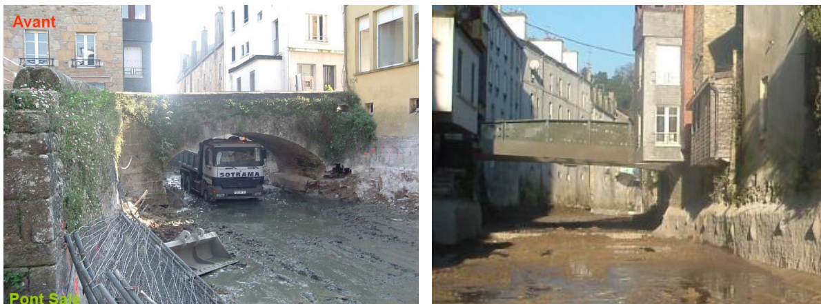
Destruction et reconstruction du pont Isole (Photo 39 : avant, et Photo 40 : après travaux)
