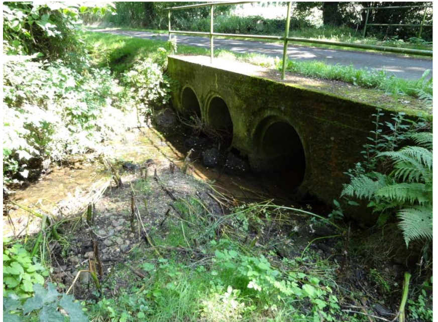
Rastal Groui en rupture d'écoulement (Kervoureau) Amont du pont – 12/08/15
