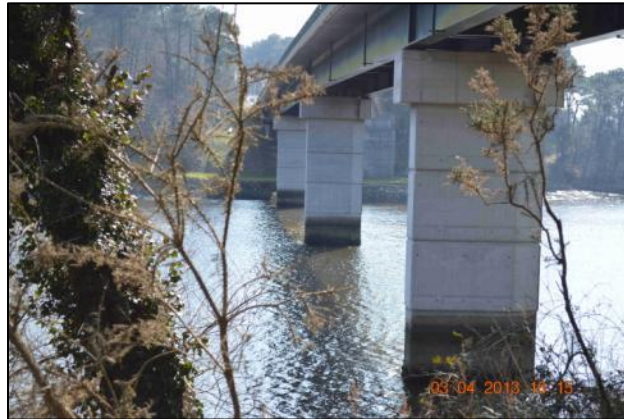
Figure 63 - Pont de St-Maurice sur la Laïta. Prises de vue du 03/04/13 par In Vivo.
