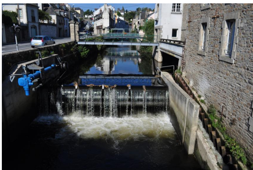
Figure 13: clapet mobile sur l'Isole.
